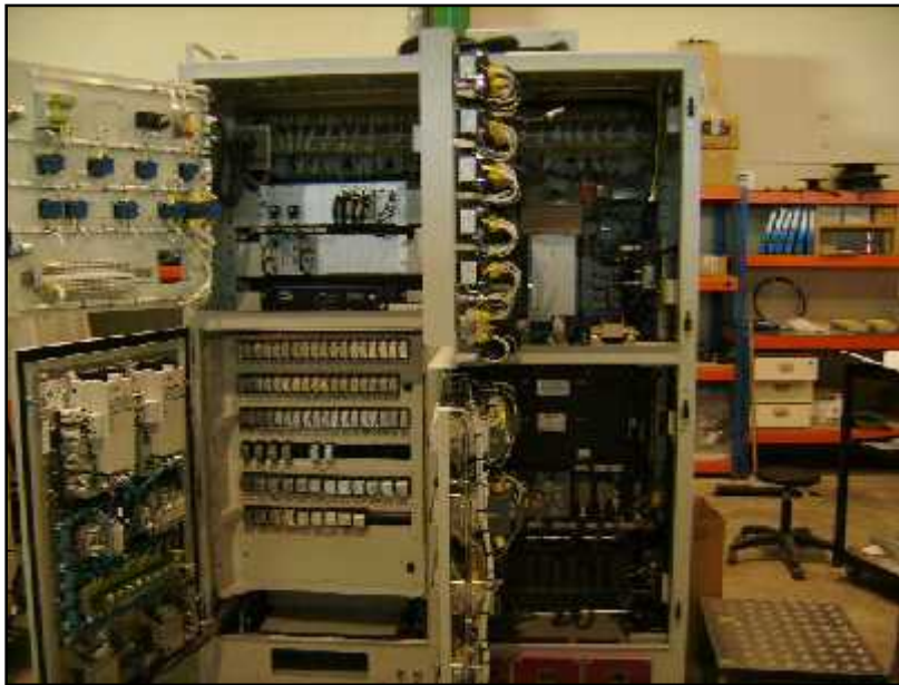
Foto ejemplo Armario Control
