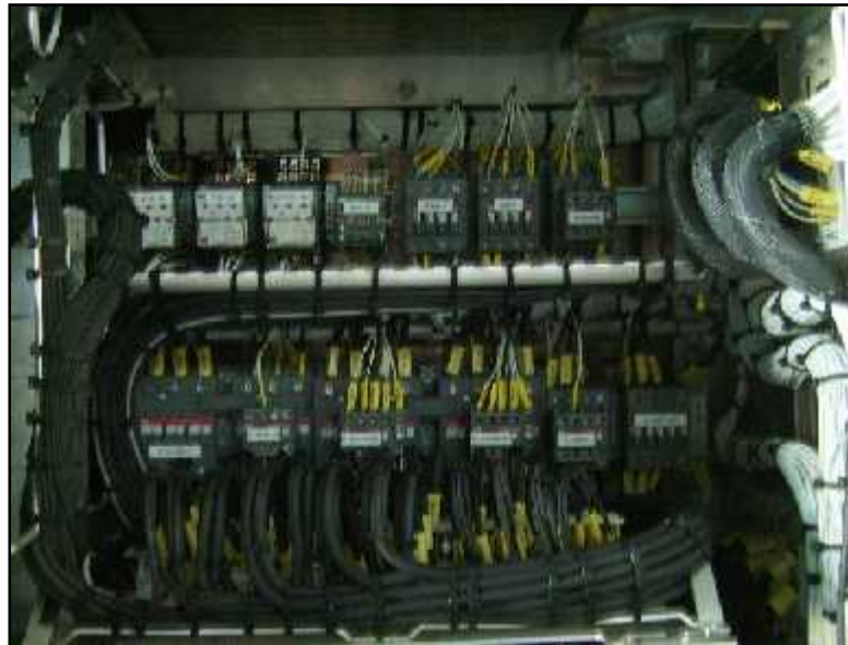
Foto ejemplo placa de contactores
